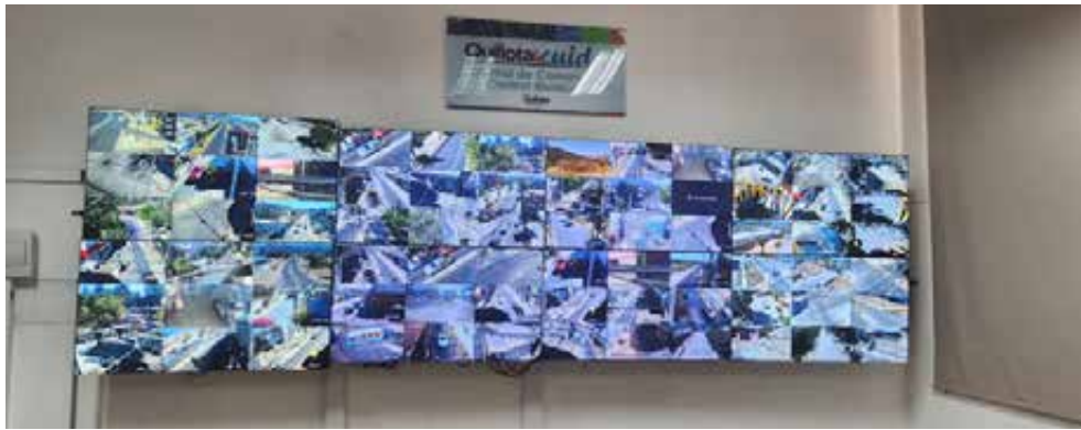
Imagen N°27: Video Wall, Sala de Monitoreo.
